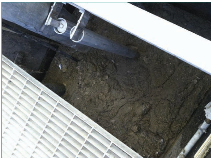
Figura 1: Con la rejilla abierta, es posible observar una capa de grasa de 2-3 pies antes del tratamiento.
